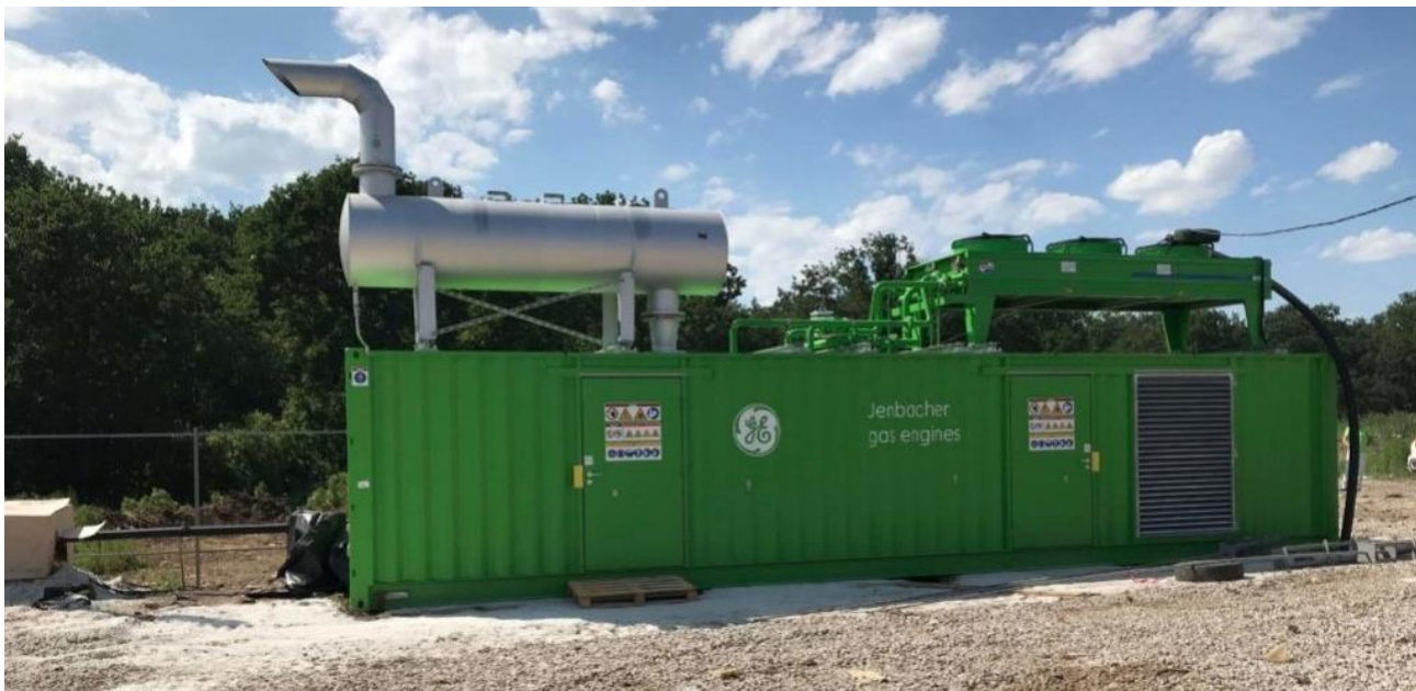
Рисунок 115 – Когенераційна установка потужністю 600 кВт на полігоні твердих побутових відходів в м. Кропивницький
