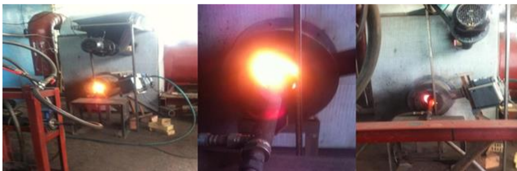
Рис 4.9 – Робота теплогенератора в КП "Теплоенергетик"
