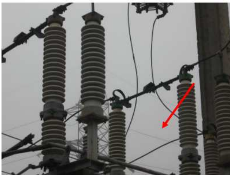
Рис. 4.11. Зовнішній вигляд дефектного з'єднання
