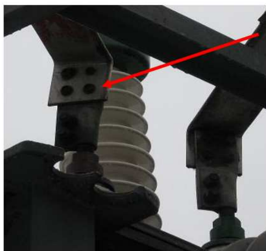
Рис. 4.9. Аварійна ділянка шини
