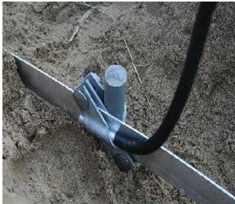
Рис. 5.2. Зовнішній вигляд заземлювача
