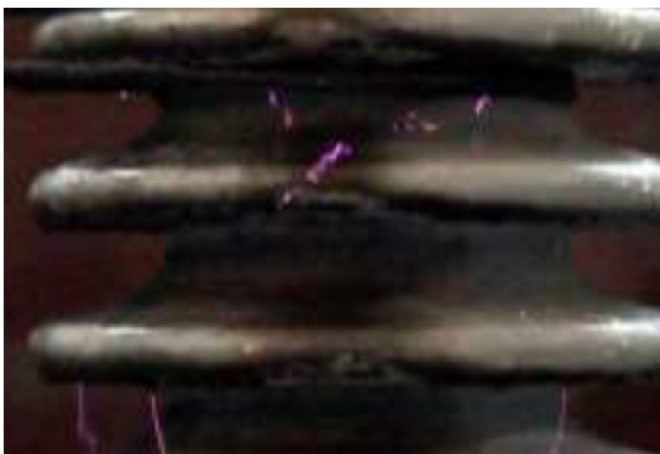
Рисунок 1.6 – Часткові розряди вздовж поверхні ізолятора
