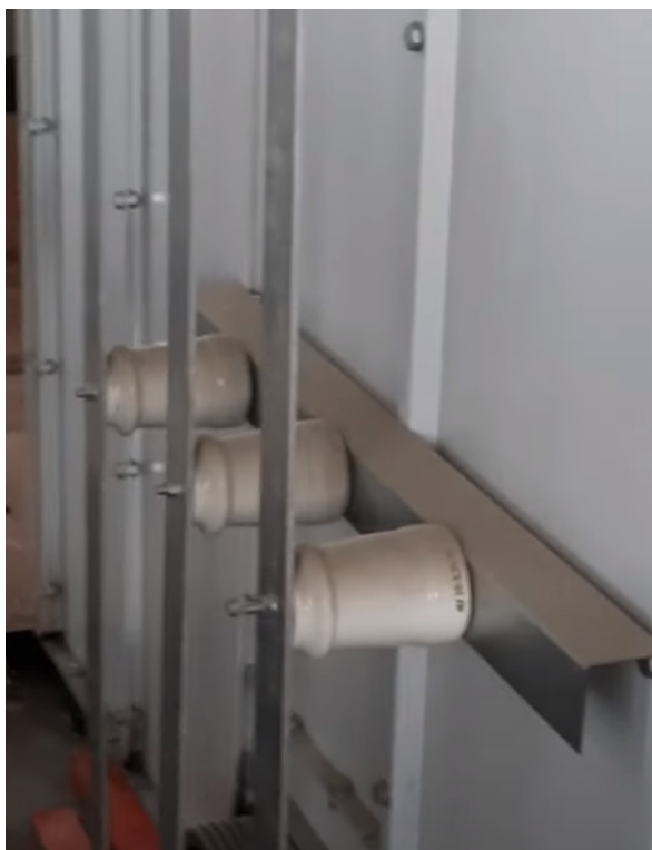
Рисунок 1.5 – Забруднення ізоляторів ВН КТПк трансформаторного відсіку
