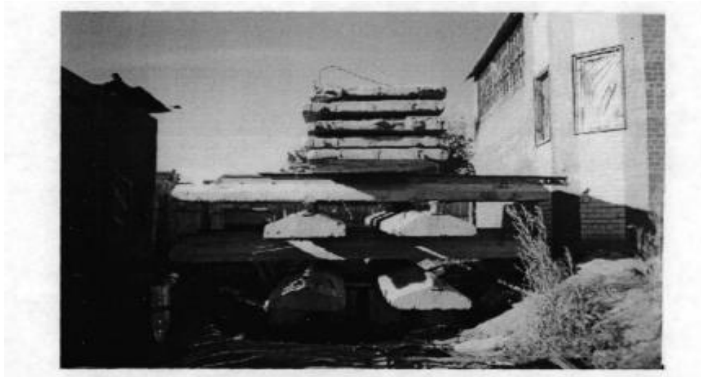
Рис. 3.4 Стрічковий фундамент з низьким розтверком під навантаженням.
