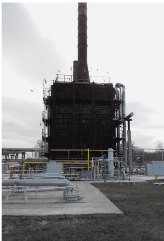
Рисунок 1.3 – Загальний вигляд трубчастої печі
