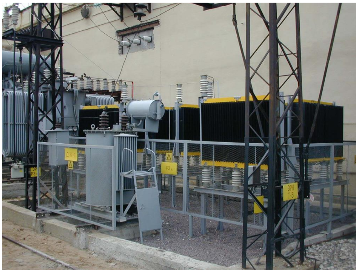
Рис. 3.16. Резистори РЗ-4000-102-35 на ВРП-35 кВ
