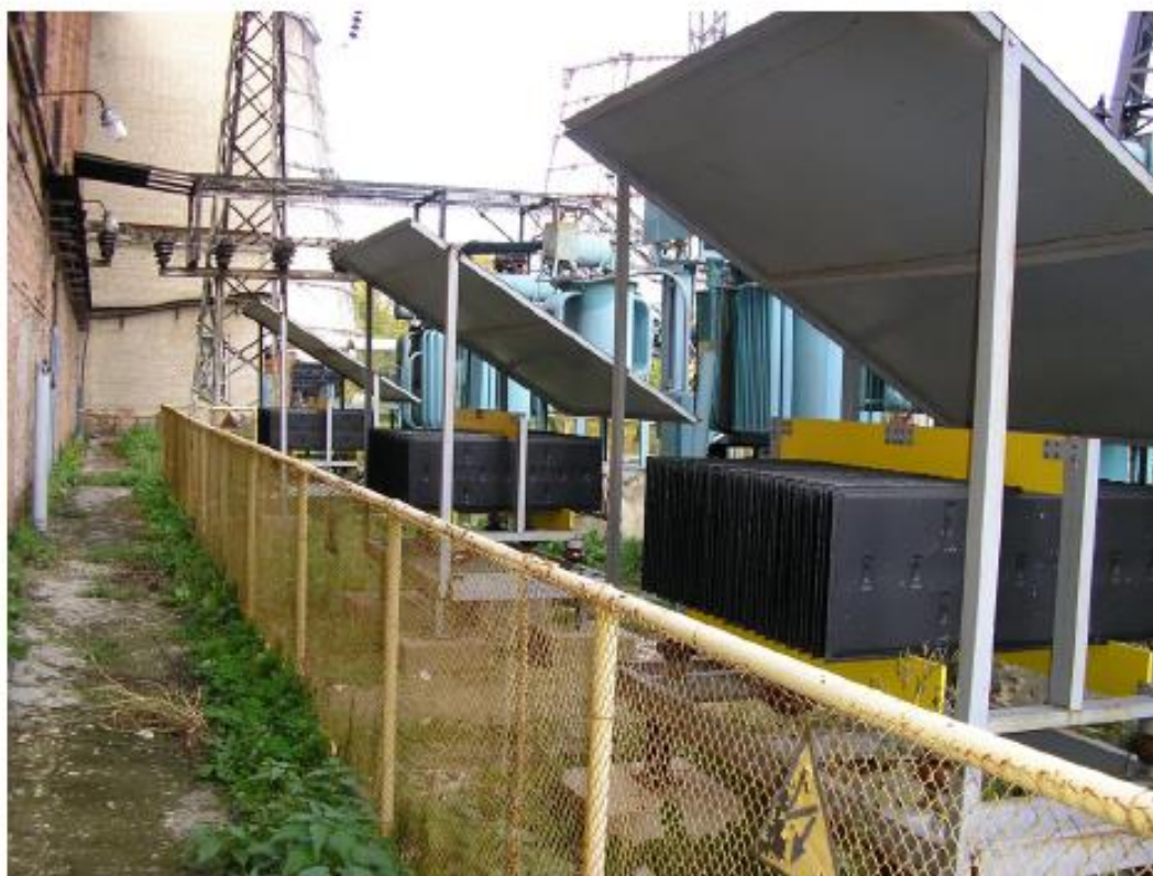
Рис. 3.15. Резистори РЗ-800-15-6 в мережі ГРП ТЕЦ 6 кВ
