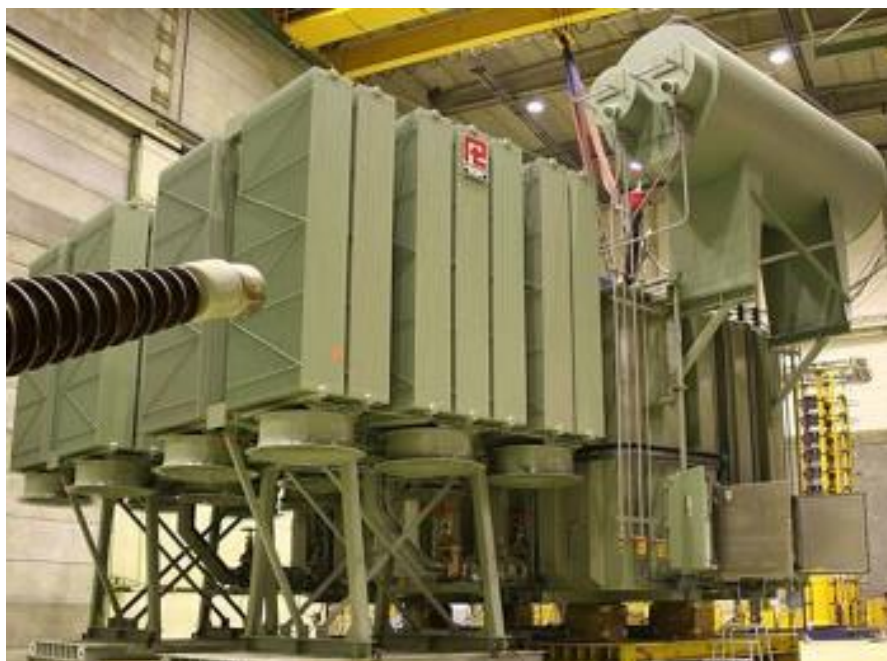
Рис. 3.1.6 - Фазоповоротний трансформатор, вид на радіатори системи охолодження
