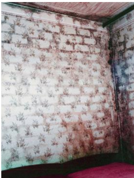
Рисунок 2.2 – Стан теплової відмови стіни з утепленням з боку приміщення листами пінополістиролу товщиною 50 мм та цегляною кладкою в \frac{1}{4} цегли.
