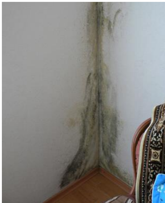
Рисунок 2.1 – Стан теплової відмови в кутових зонах стін житлових приміщень.
