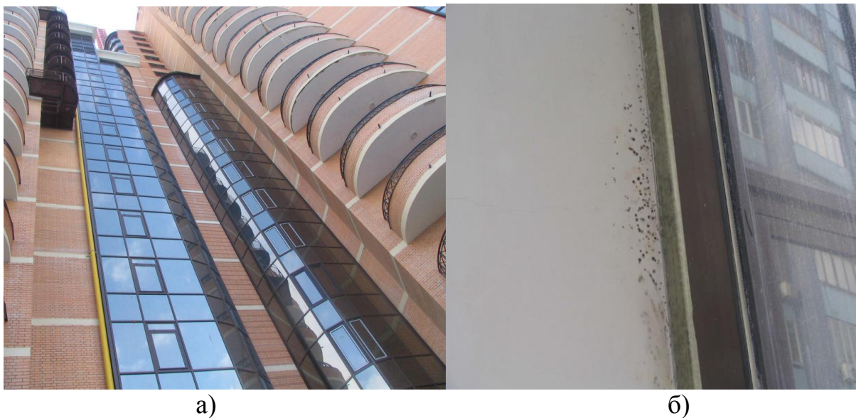
Рисунок 2.3 – Зовнішній вигляд елемента фасаду будинку (а), термін експлуатації якого 3 місяці, та зафіксований стан теплової відмови (б) зовнішніх стін.
