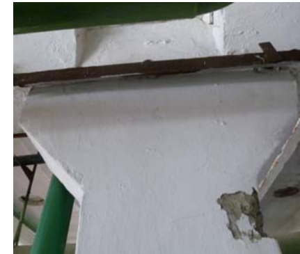
Рисунок 2 – Пошкодження консолі залізобетонної колони
