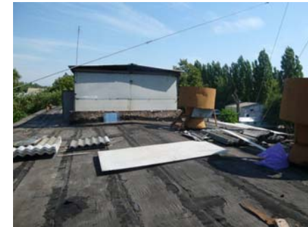
Рисунок 3 – Здуття та розтріскування гідроізоляційного килиму, наявність будівельного сміття та біозабруднення
