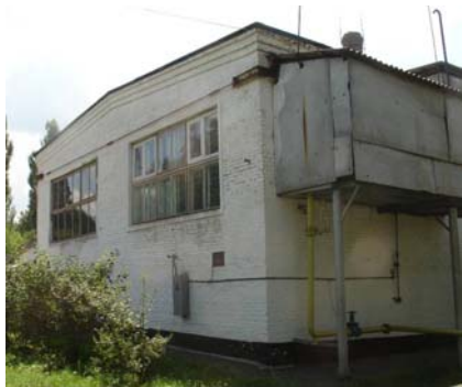
Рисунок 1 – Похилі тріщини у цегляних зовнішніх стінах
