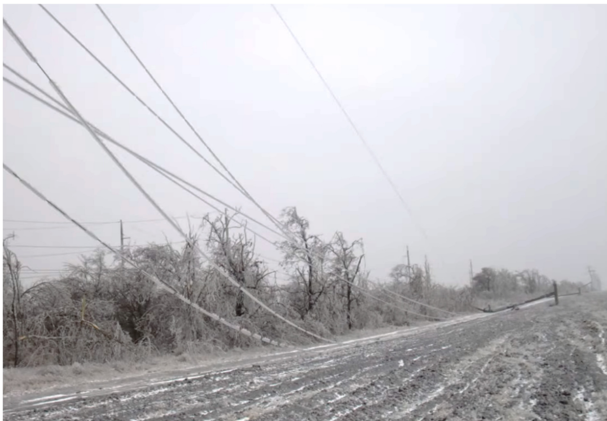
Рисунок 1.1 – Злам залізобетонної опори ПЛЕ 110 кВ
