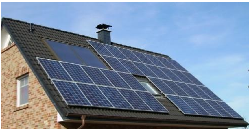
Рис. Г.2 – Сонячні батареї, встановлені на даху будинку
