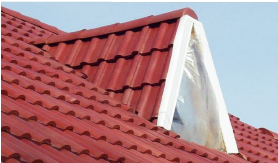
Рисунок 6 – Покрівля з полімерно-піщаної черепиці
