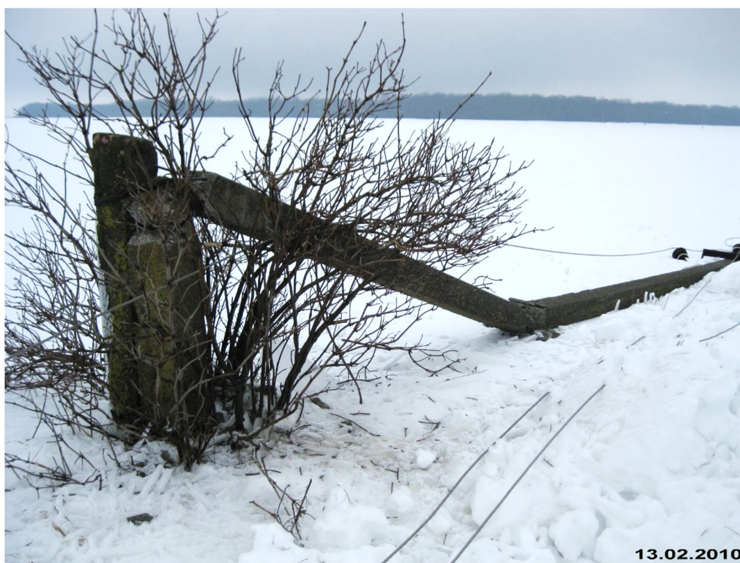
Рисунок 1.1 – Злам залізобетонної опори ПЛ 10 кВ
