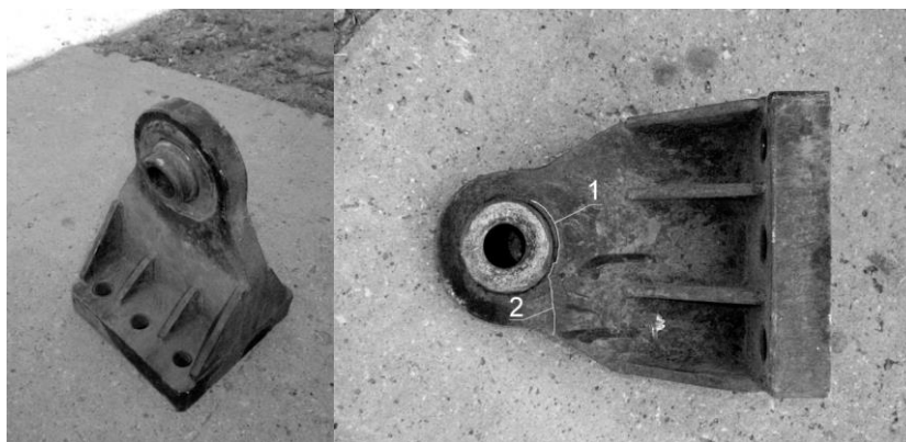
1 – тріщина по зварному шву підшипника; 2 – тріщина по основному металу
