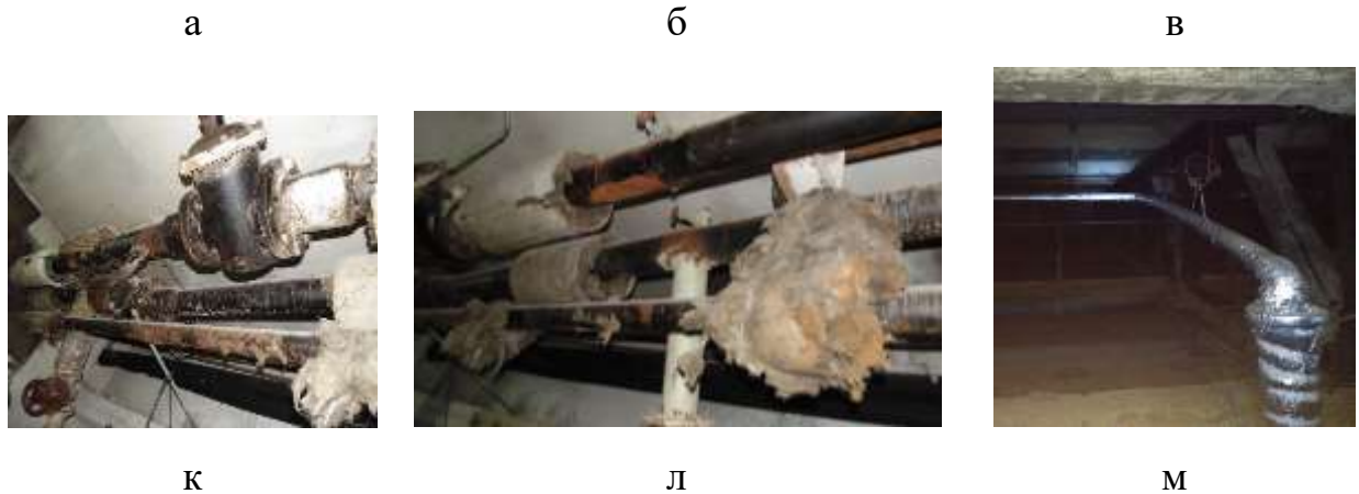
Рисунок 2.4.13. Трубопроводи систем опалення, гарячого та холодного водопостачання
