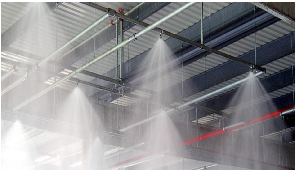
Рис. 1.1. Установка автоматичної системи пожежогасіння
