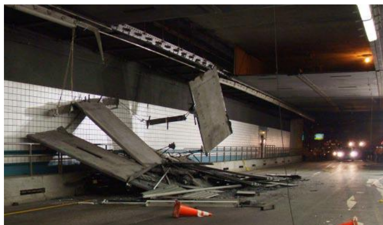
Рис. 1.1 Руйнування клейового анкера під час обвалення стелі тунелю
