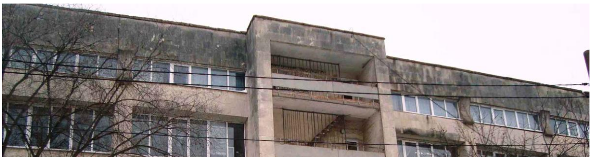
Рисунок 2.15. Пліснява на горі фасаду
