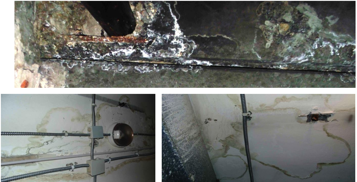
Рисунок 2.16. Конденсована волога, іржа, руйнування конструкцій
