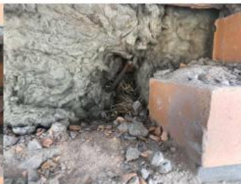
Рис. 2.14 – Неоднорідність і низька якість теплоізолюючого шару огорожуючої конструкції
