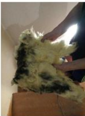
Рис. 2.8 – Пилуваті відкладення в утеплювачі в області бруса-мауерлату
