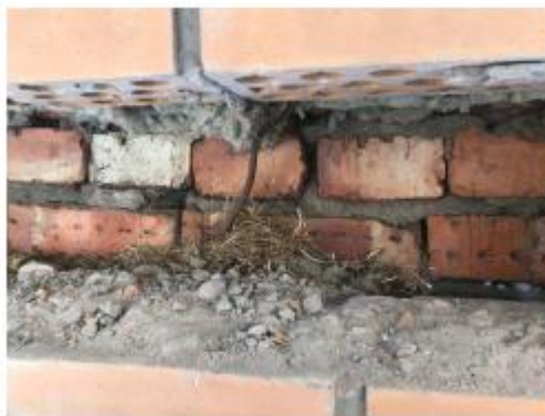
Рис. 2.13 – Дефекти в кладці у вигляді неоднорідності розчину та щілин
