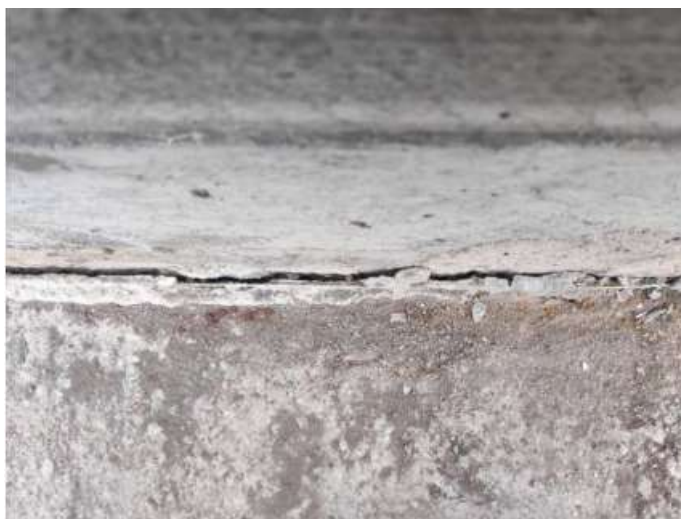
Рисунок 2.5 – Тріщина між будівлею та вимощенням.
