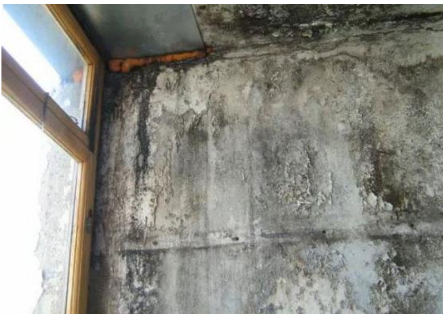
Рис.98. Конденсація води та цвітіння на поверхні стін без утеплення у приміщенні з підвищеною вологістю
