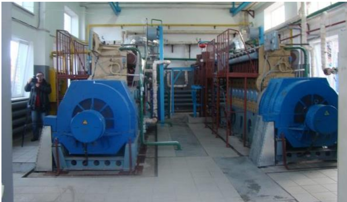
Рис.134. Розміщення когенераційних установок ДвГА-630 виробництва «Первомайськдизельмаш» в пристосованому приміщенні колишнього тепlopункту
