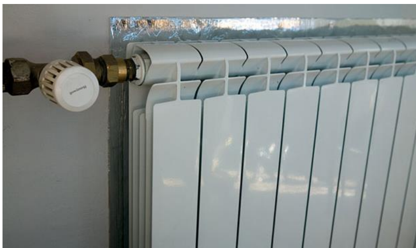
Рис.114. Тепловідбиваючий екран, який встановлено позаду батареї опалювання.
