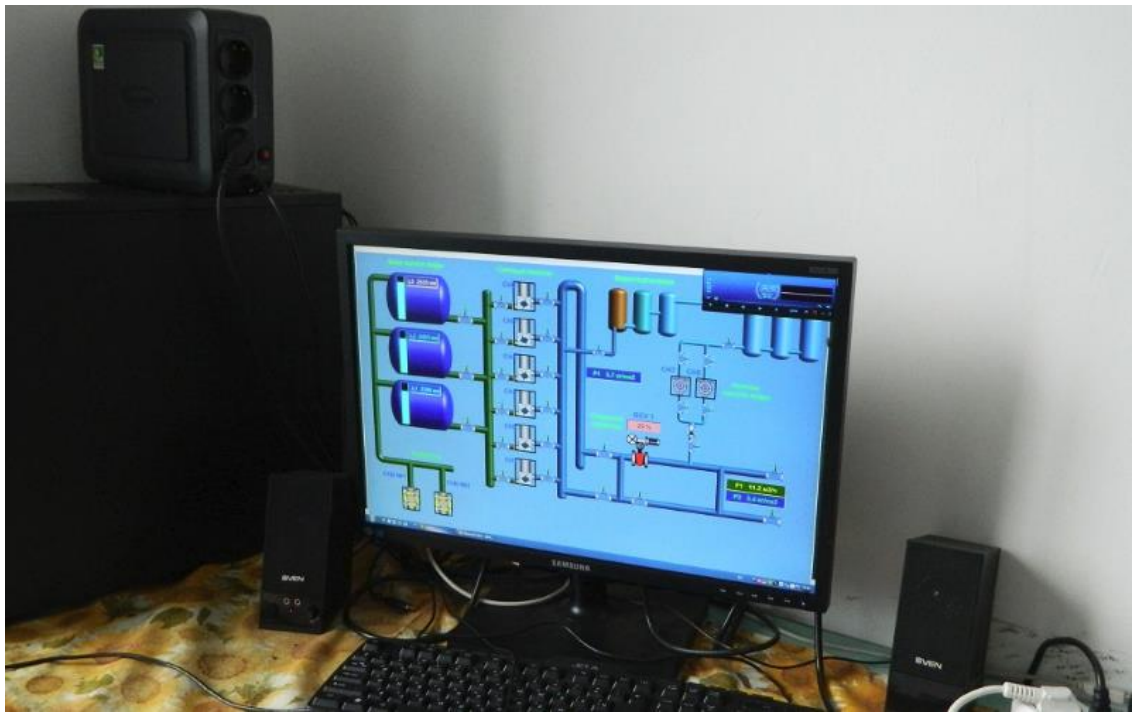
Рисунок 4.1 - Загальний вигляд розробленого АРМ
