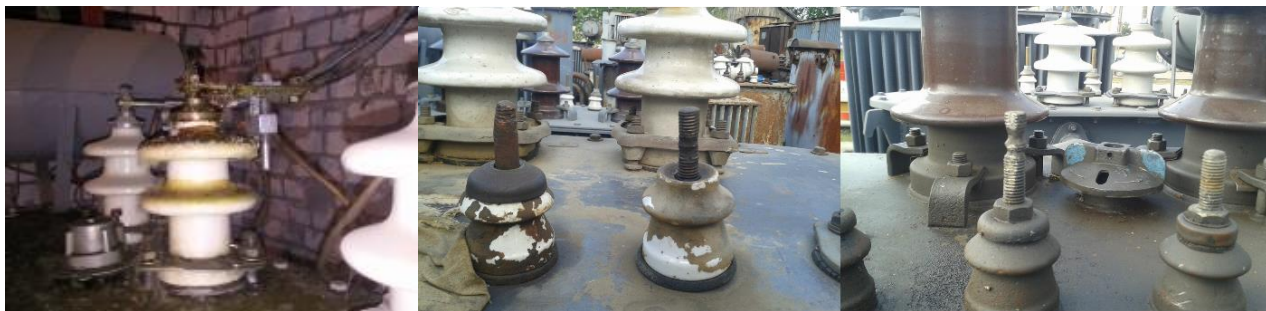
а) пошкодження струмоведучих шпильок
