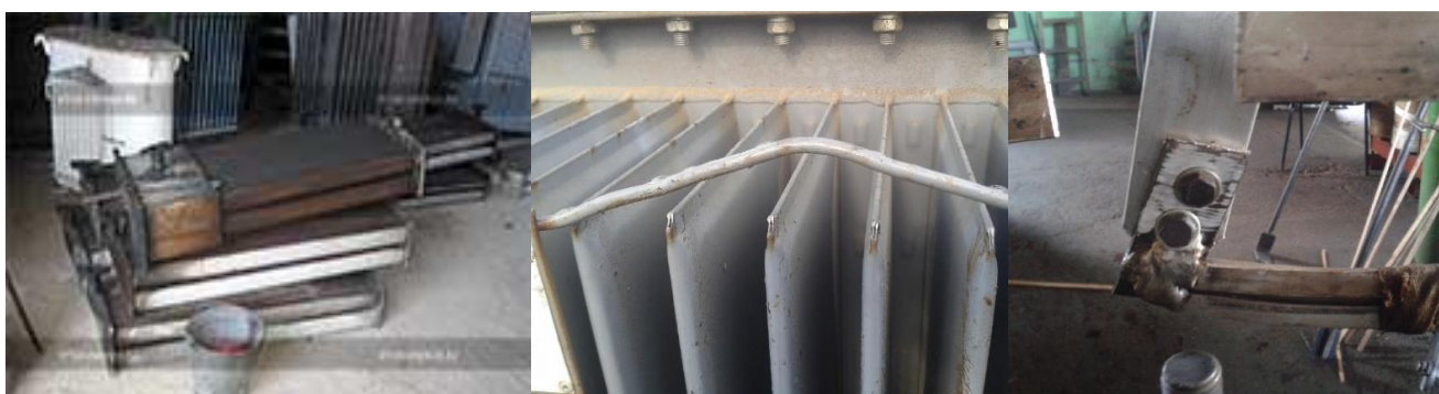
в) пошкодження від перегріву
