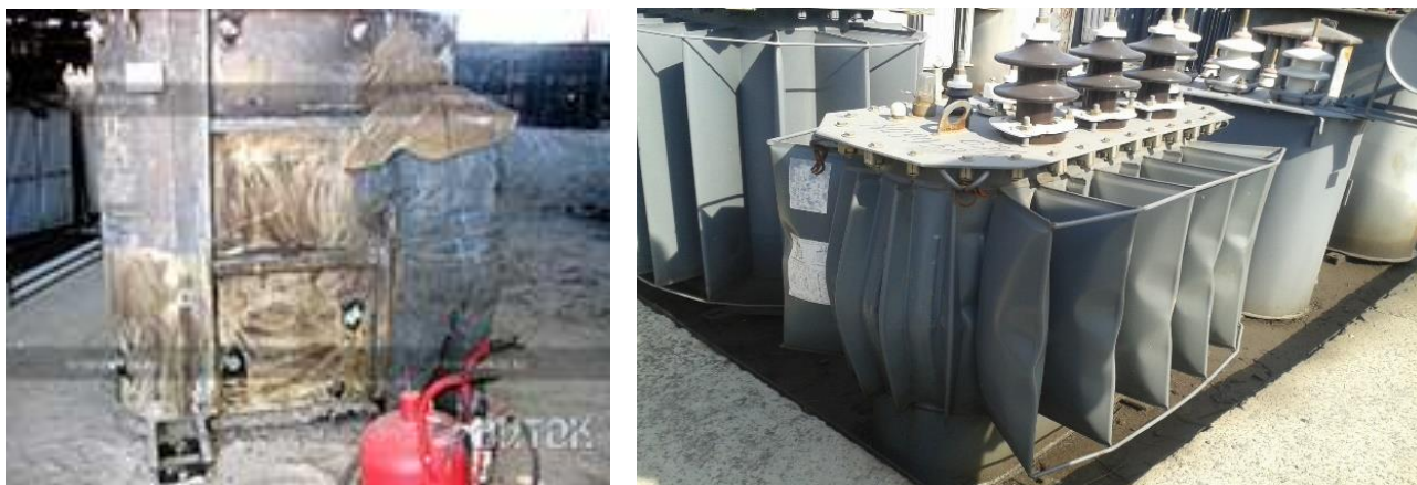
б) пошкодження корпусу силового трансформатора
