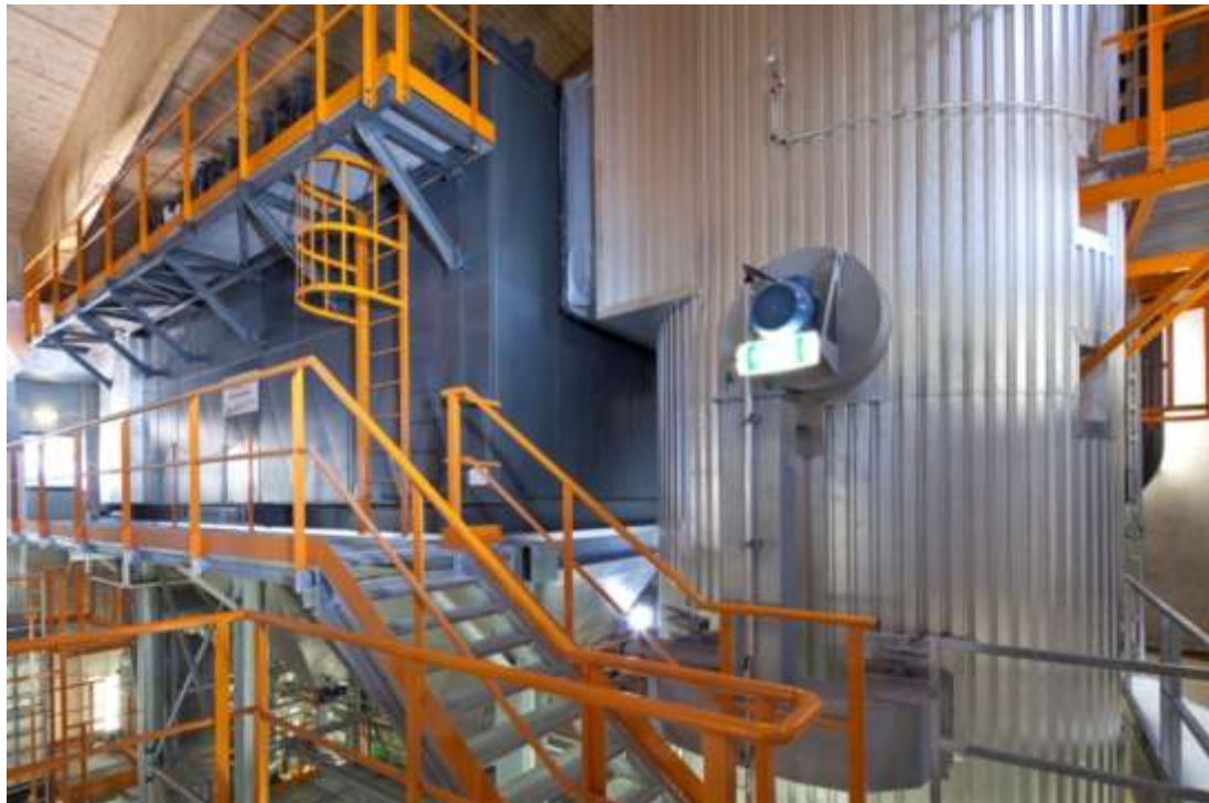
Рисунок 9.8. Загальний вигляд змонтованої термомасляної котельної установки на деревних відходах із системою очищення димових газів
