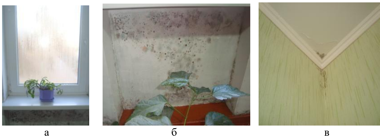
Рис. 1.6. Наслідки відсутності вентиляції: а – запотіле вікно; б, в – пліснява й грибок
