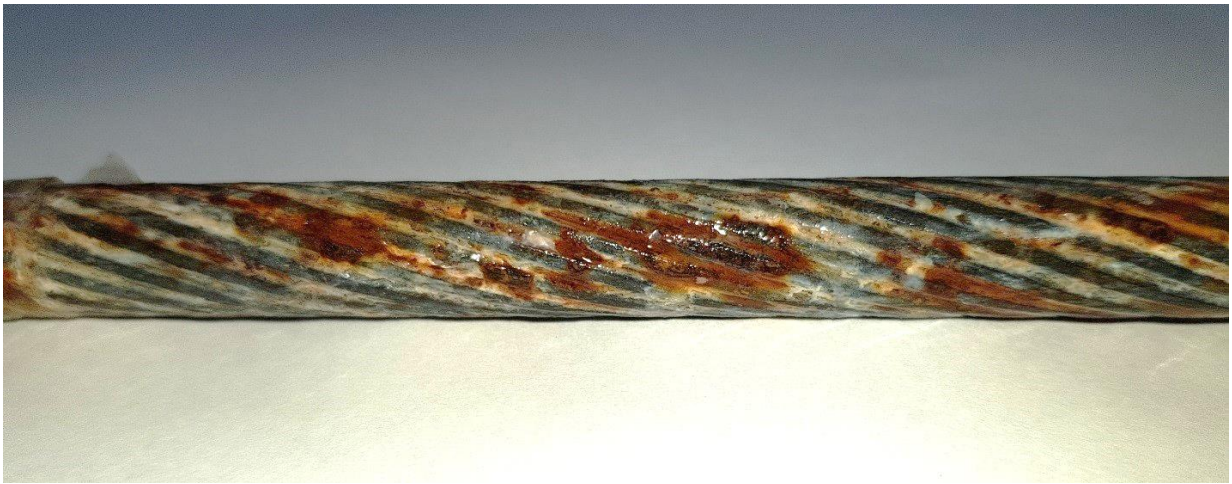
Рисунок 2.2 - Множинні дефекти гроззахисного троса внаслідок корозії
