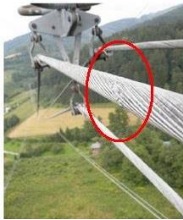
Рисунок 2.3 – Електротеплові дефекти проводу типу АС
