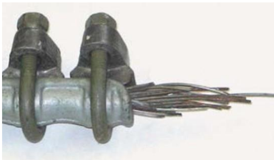
Рисунок 2.4 – Обрив проводу на вході натяжного затискача типу НБН внаслідок галопування проводу
