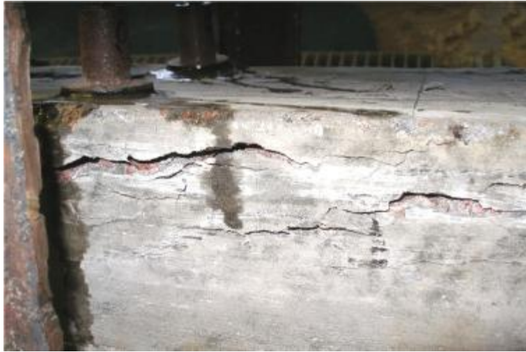
Рис. 2.6. Роздроблення бетону стислої зони балки КПОВ- 6
