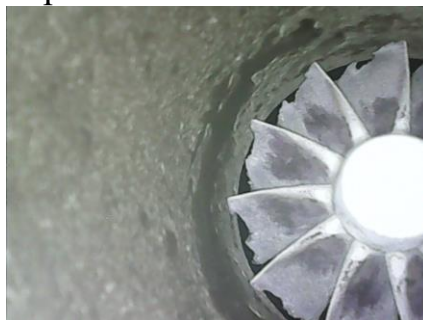
Рисунок 3.5 – Руйнування крильчаток турбіни турбокомпресора
