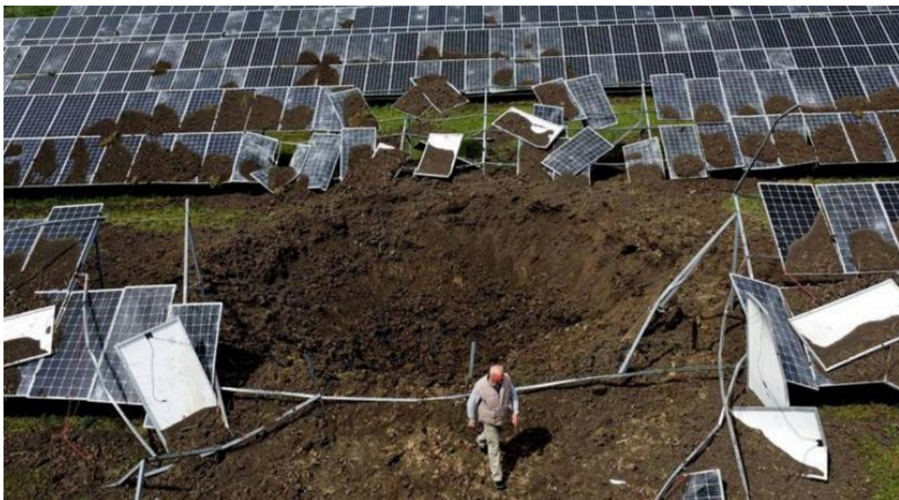
Рис. 2.5 Зруйновано сонячну електростанцію Харківського енергетичного кластера (1,2 МВт) у Мерєфі
