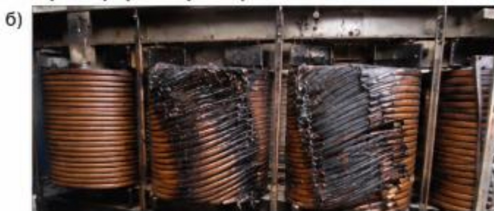
Рисунок 7.1 – Пошкодження турбогенератора та трансформатора через виткові кз: а) пошкодження статора турбогенератора через виткові короткі замикання; б) пошкодження обмоток трансформатора через виткові короткі замикання
