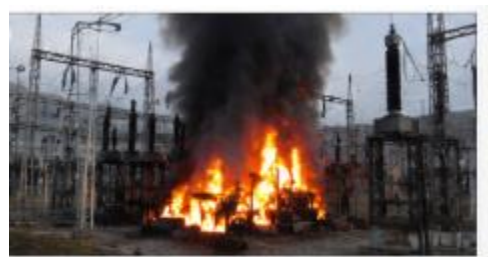
Множинне КЗ з пожежею на підстанції
