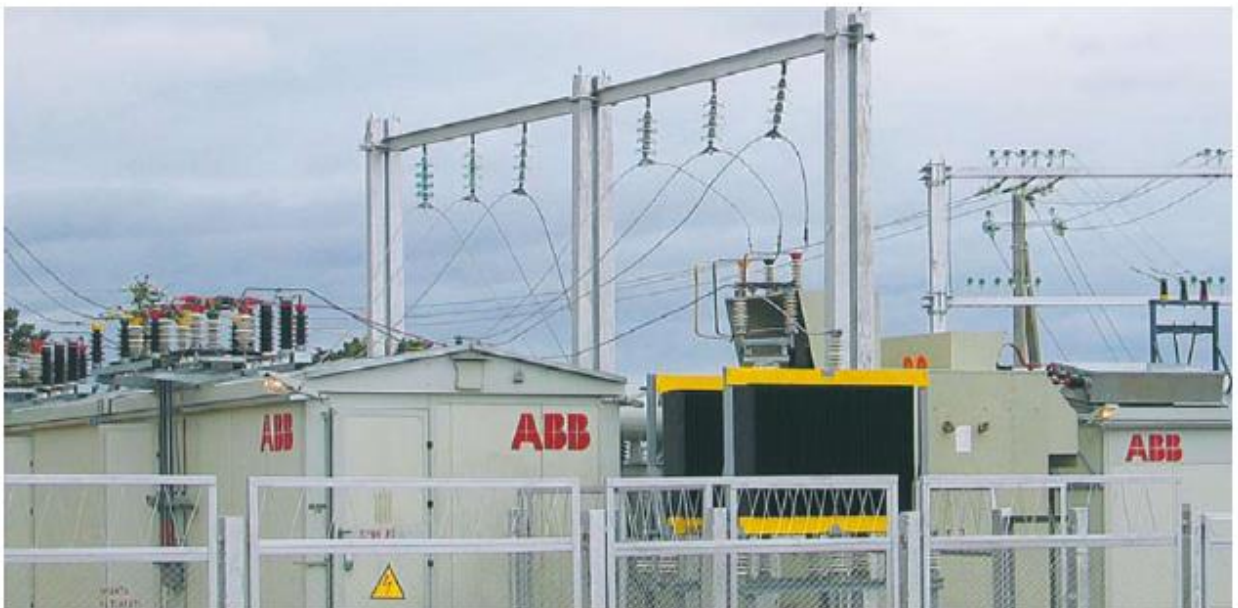
Рис. 3.9. Резистор РЗ-8000-51-35 на підстанції 150/35/10 кВ
