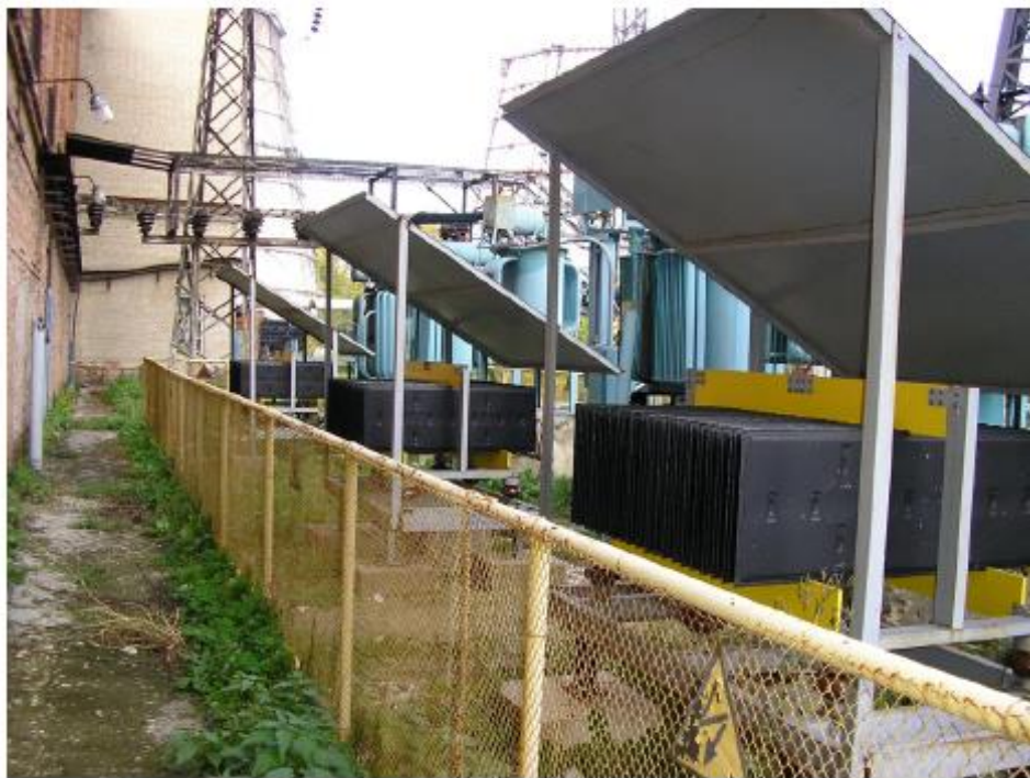
Рис. 3.11. Резистори РЗ-800-15-6(10) в мережі ГРП ТЕЦ 6-10 кВ
