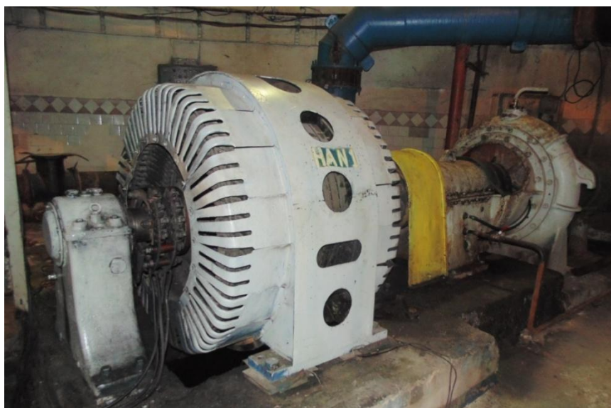
Рисунок 3.2.5 - Силове електрообладнання КНС
