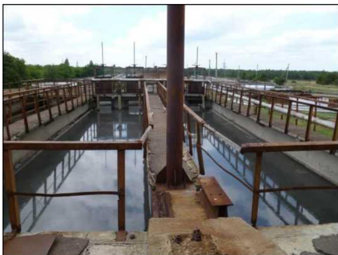
Рисунок 2.5.3 – Пісковловлювачі, що вимагають реконструкції
