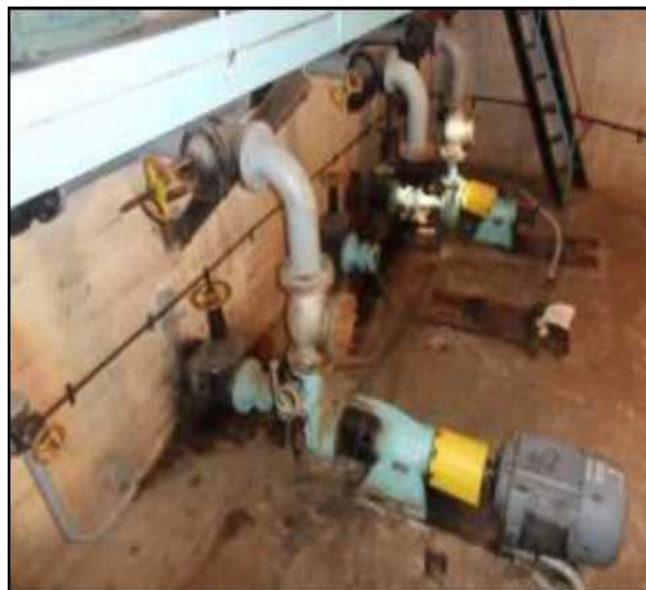
Рисунок 2.4.3 – Існуючий стан, відсутня помпа
