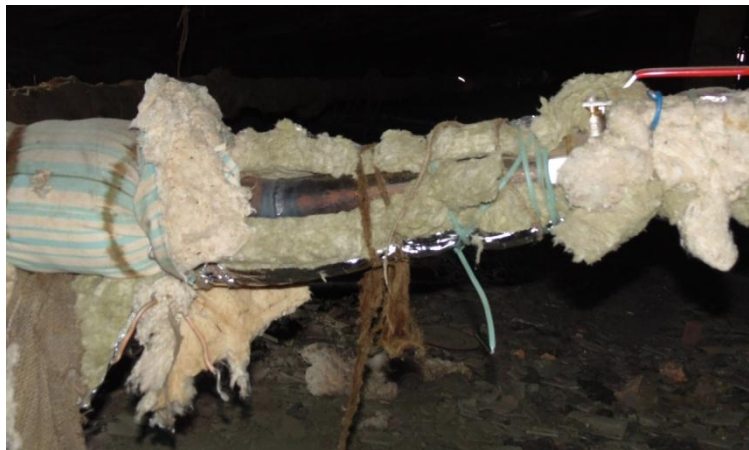
Рисунок 3.1.1 - Стан ізоляції на ділянках теплової системи адміністративного корпусу
