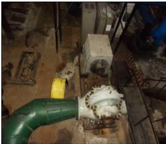
Рисунок 2.4.2 – Відсутнє помпове устаткування на помповій станції
