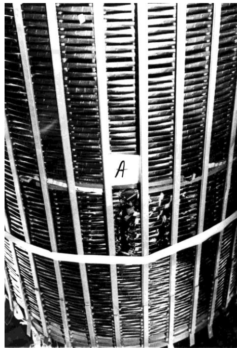
Рис. 1.1 – Фото втрати радіальної стійкості обмотки силового трансформатора типу ТДЦ-250000/220
