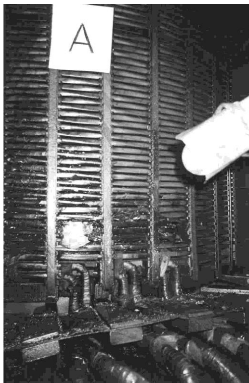
Рис. 1.2 – Виткове замикання в обмотці низької напруги трансформатора типу ТДЦ-250000/220
